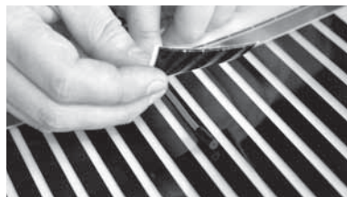
Рис. 15. Датчик прикрепляется к термопленке битумной изоляцией
