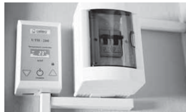
Рис. 19. Терморегулятор, подключенный к сети через отдельный автомат
